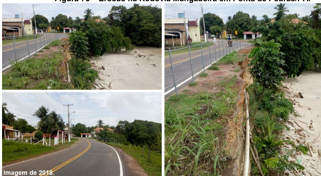
Figura 75 – Erosão na Rodovia Mangabeira em Ponta de Pedras/PA.
