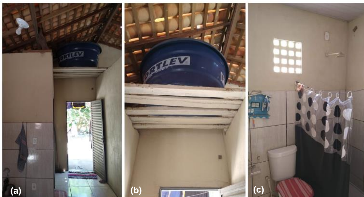
Figura 86: Parte interna das casas do MCMV- Rural, I em Vila de Armazém (a,b,c).
