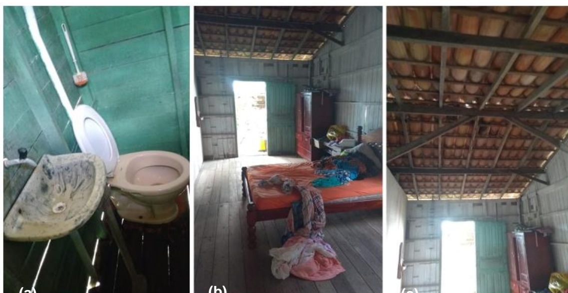
Figura 48: Casas do MCMV- Rural na Ilha do Meio finalizadas e ocupadas (a, b, c)
